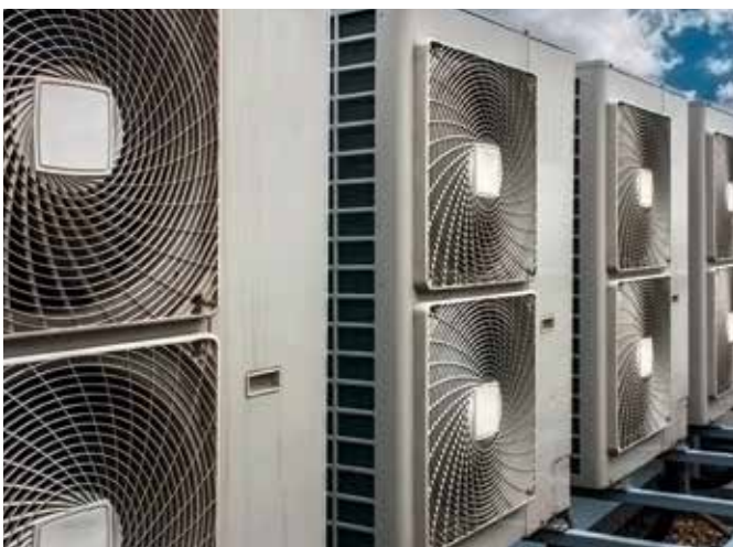
Klima- und Lüftungstechnik
