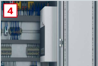
4 Kühlgerät für die Schaltschrank- temperierung
