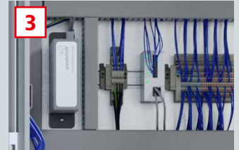
3 Modulare B & R „IPC-Steuerung“ mit Powerlink
