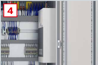
4 Kühlgerät für die Schaltschrank- temperierung
