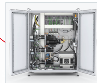
Der Dosiermaschinen-schrank beinhaltet die Komponenten der Dosierperipherie, wie z. B. die Dosierpumpen.
