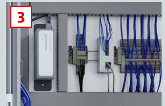
3 Modulare B & R „IPC-Steuerung“ mit Powerlink
