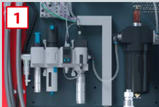
Druckluftanschluss, Trockner und Wartungseinheit
