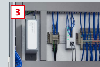
Modulare B & R „IPC-Steuerung“ mit Powerlink
