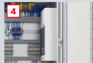
Kühlgerät für die Schaltschranktemperierung
